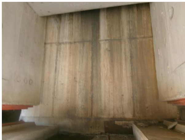
궁촌1교 하행선 교대 A1 누수흔적 4.0*3.0 -신규-
