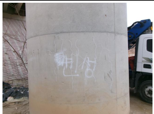
궁촌1교 하행선 교각 P1 망상균열 0.2*1.0*0.5 -신규-
