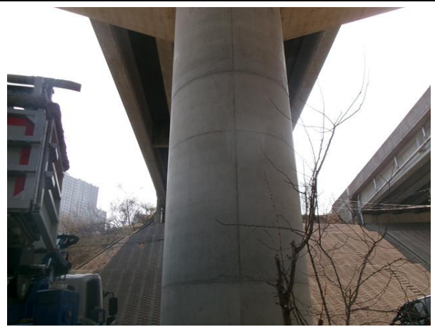
궁촌1교 하행선 교각 P1 균열 0.2/3.0 -신규-
