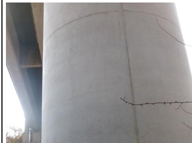
궁촌1교 하행선 교각 P1 균열 0.2/3.0 -신규-
