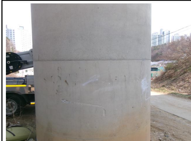
궁촌1교 하행선 교각 P1 망상균열 0.2*1.0*0.5 -신규
