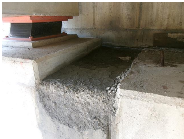
궁촌1교 하행선 교대 A1 파손 1.0*3.0 -신규-
