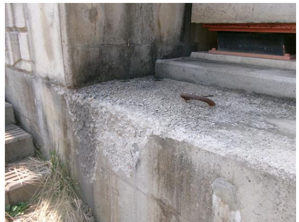
궁촌1교 하행선 교대 A1 파손 1.0*2.0 -신규-
