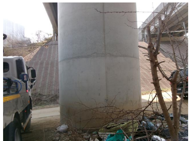
궁촌1교 하행선 교각 P1 망상균열 0.2*0.5*1.0 -신규-
