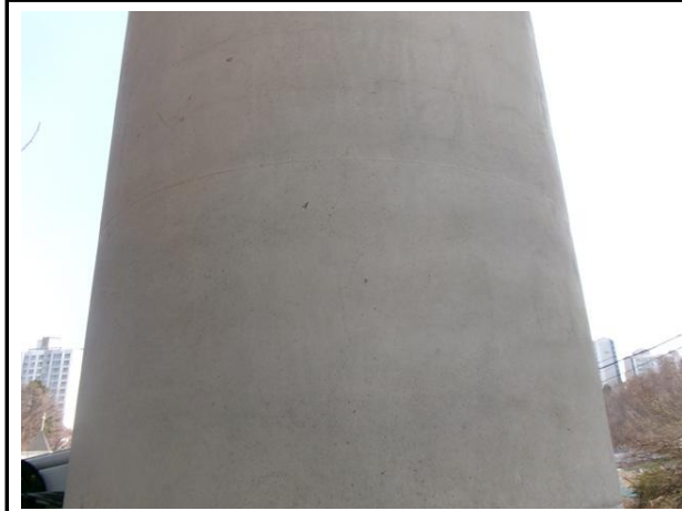
궁촌1교 하행선 교각 P1 균열 0.2/1.0 -신규-
